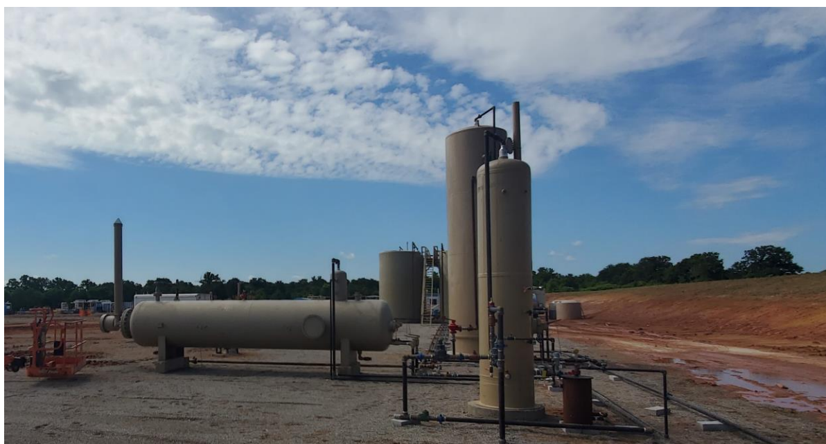
Abbildung 2: Die Produktionsanlagen von Jewell Well, Nahaufnahme mit Separatoren im Vordergrund.
