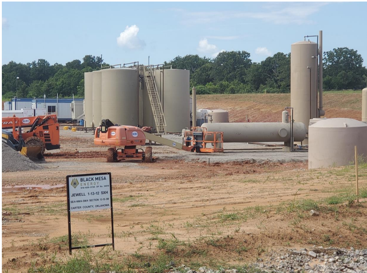
Abbildung 1: Die Produktionsanlagen von Jewell Well, Tankbatterie (Hintergrund) und Separatoren (Vordergrund).
