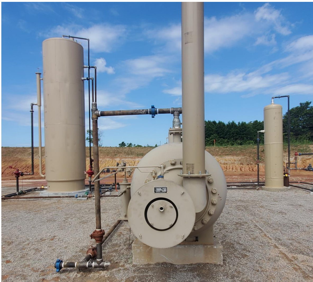
Abbildung 2: Aufgestellte und verrohrte Separatoren am Standort Jewell in Carter County, Oklahoma
