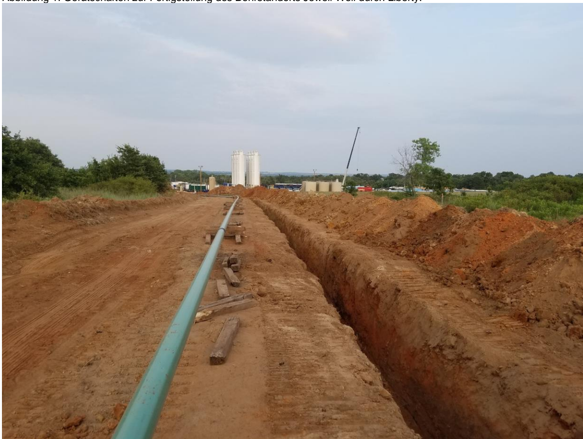
Abbildung 2: Errichtung der Gasleitung, die von der Bohrplattform Jewell Well bis zum Anschlusspunkt an die Verteilerleitung von DCP Midstream führt.
