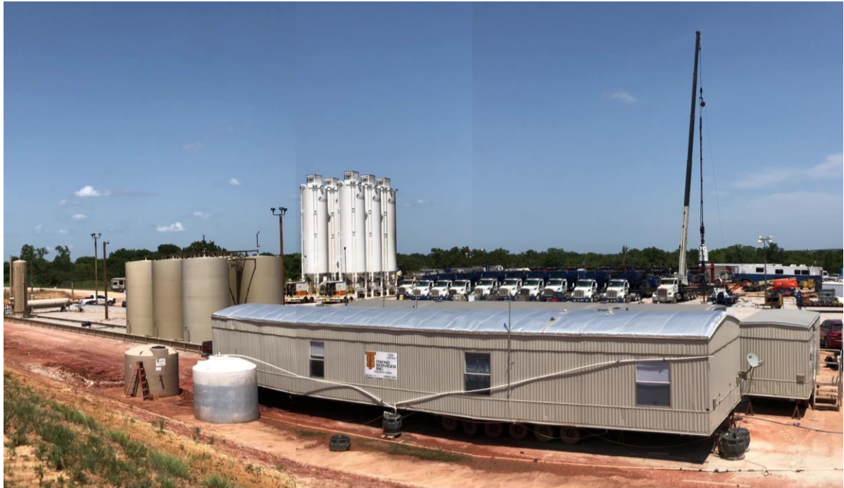
Abb. 1: Panoramablick auf die Ausrüstungen für den Abschluss des Bohrlochs Jewell, beginnend mit der mehrstufigen hydraulischen Stimulation
